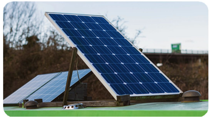
Un panel solar
