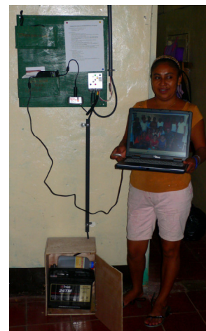
Alle Teile einer Inselanlage – ausser dem Solarpanel, das sich auf dem Dach befindet.
