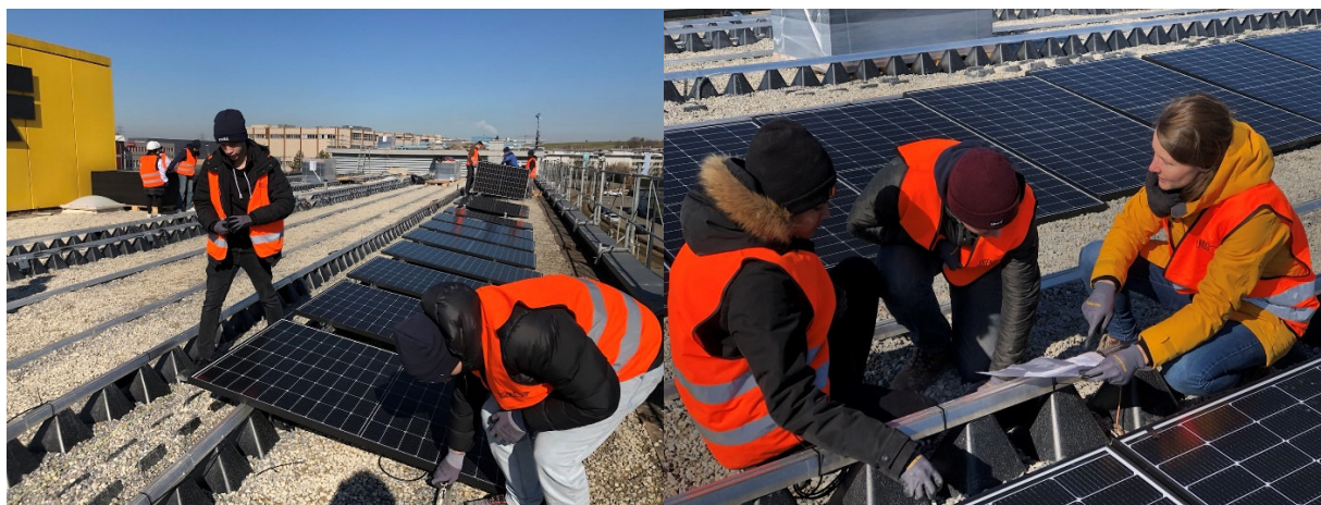
Sur un toit plat, des jeunes, encadrés par des professionnels, installent un système solaire.
