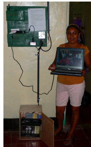
Tous les éléments d'une installation autonome - excepté le panneau solaire, qui se trouve sur le toit.
