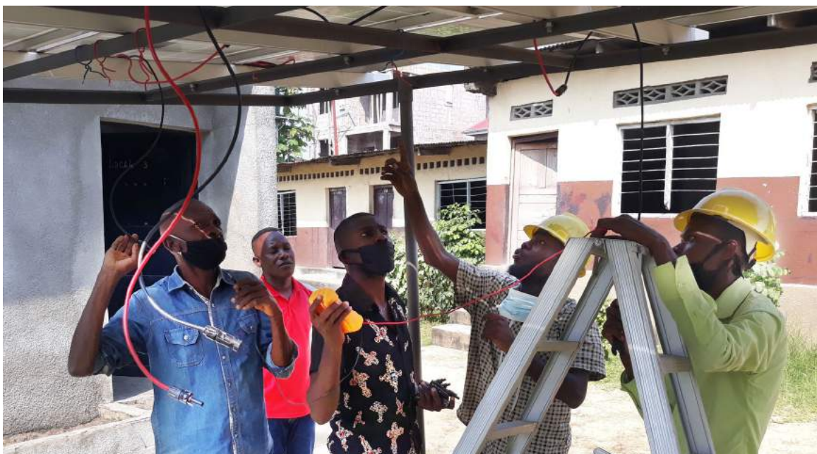
Auszubildende und Lehrer bei der Installation der hauseigenen Solaranlage an der Eproba.
