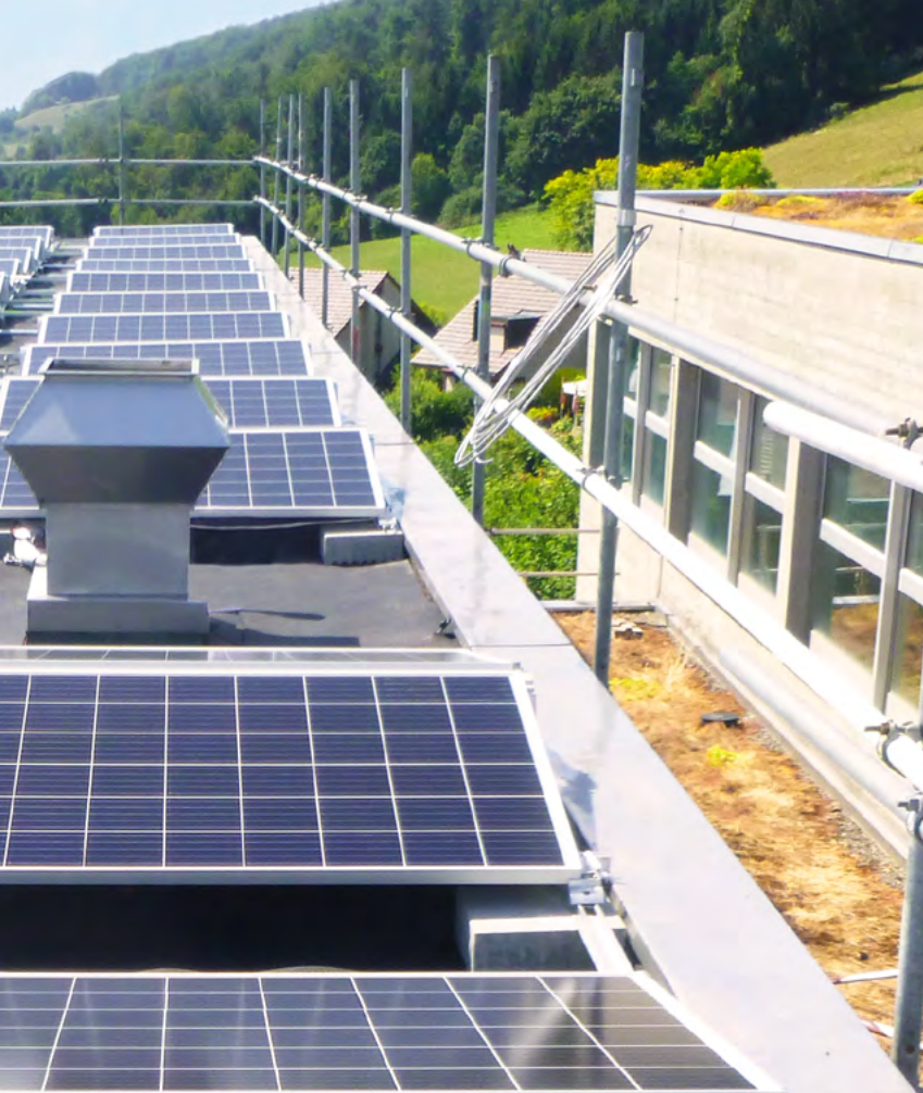
Ein Teilnehmer hilft im Rahmen seines Praktikums bei der Installation von Solarmodulen.
