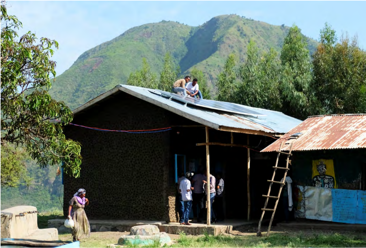
Solarinstallation auf der abgelegenen Primarschule Arada.
