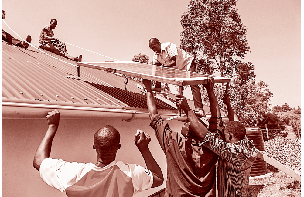
Teilnehmende des Solartrainings vom September 2016 in Abura, Kenia, bei der Installation einer Solaranlage. Solafrica
